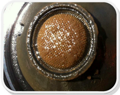
Sulama Valve filtresi HOCL uygulamadan önce
